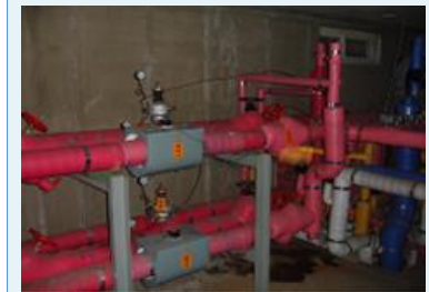
• 동별 차압유량조절밸브 점검
