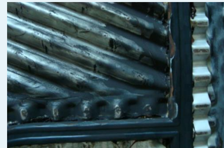
가스켓 하부 이물질 침적 사진
