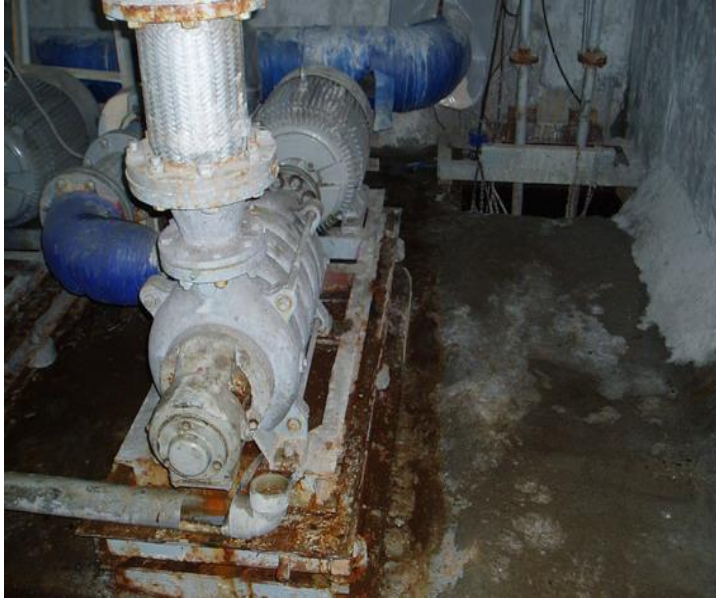
드레인 배관 설치 불량
