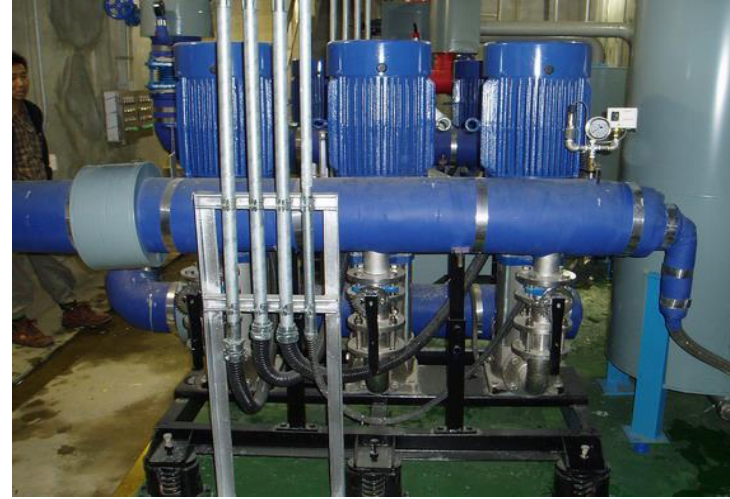
헤더 보온 처리 양호
