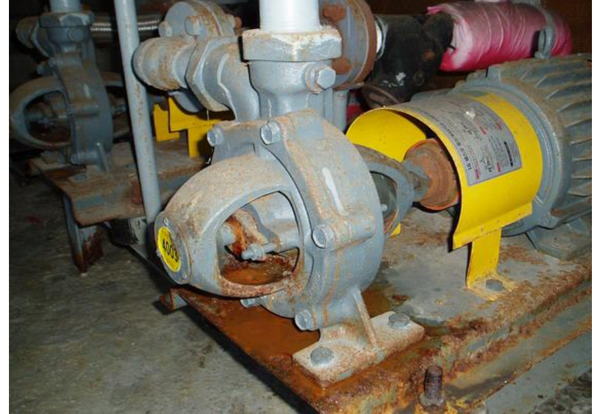
드레인 배관라인 없음 # 펌프 주위 부식성 심각
