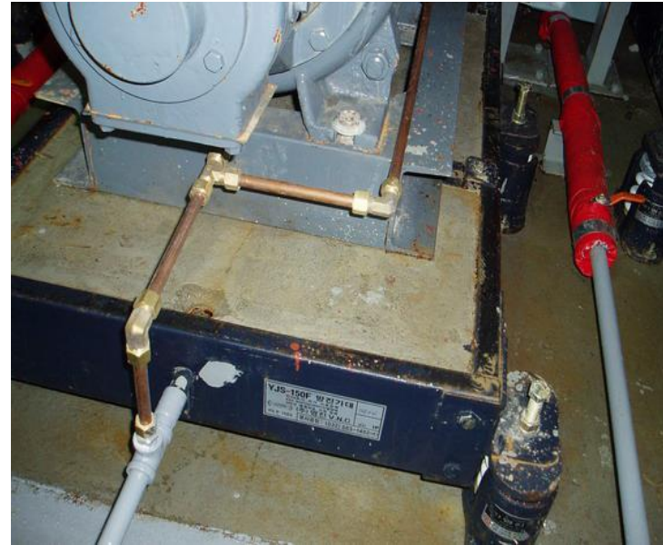
드레인 배관 설치 양호
