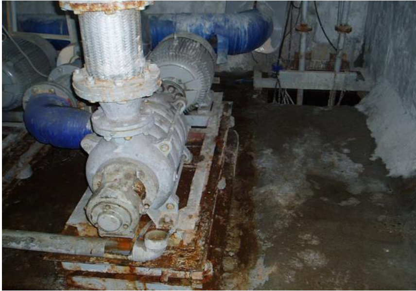
드레인 배관 마감 처리 미흡
