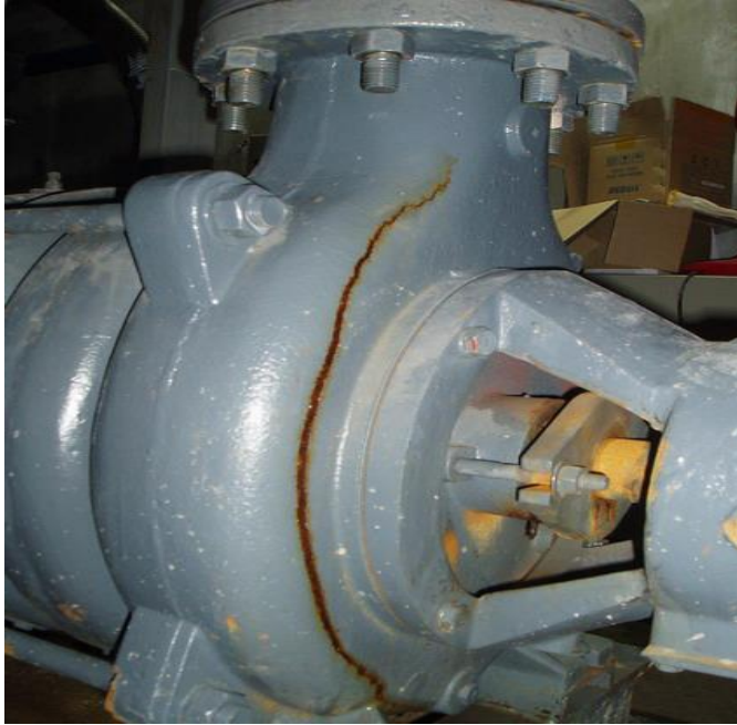
수격에 의한 케이싱 파손
