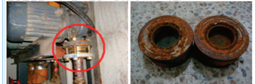
• 급탕펌프 체크밸브 교체시행 • 체크밸브 부식고착(동작불능)
